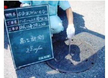
マンホール蓋凹部3.5mm
